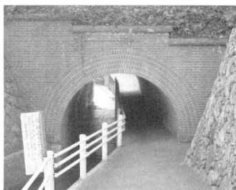
拡幅が望まれる山家入口のトンネル道
