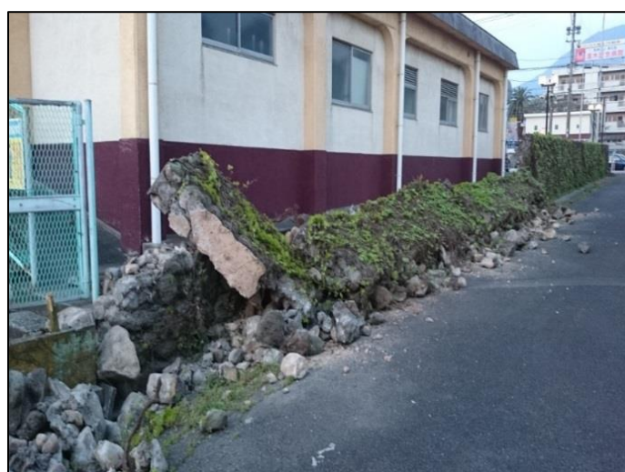
写真 北部地区公民館 石積擁壁の損壊
