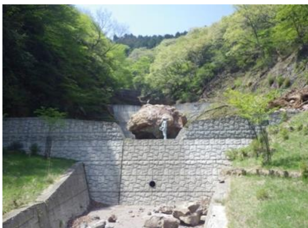
写真 南立石治山ダムの被害 （撮影 大分県）
