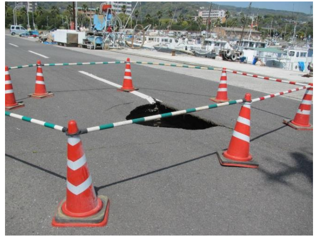
写真 亀川漁港道路の陥没
