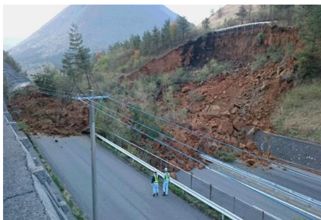
写真 由布岳PA付近の崩土（撮影 大分県）
