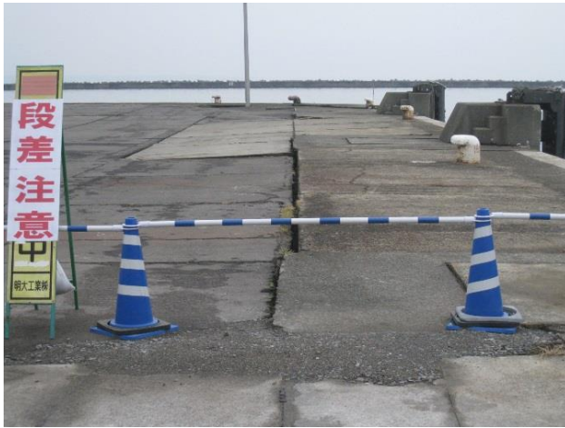
写真 国際観光港の被害
