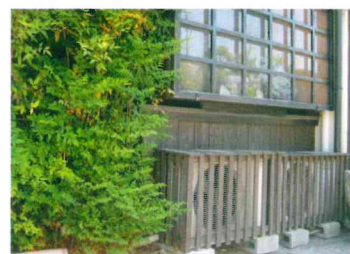
修景措置を施した室外機
